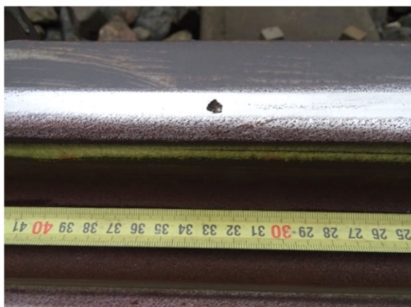
Povrchová vada na křídlové kolejnici
