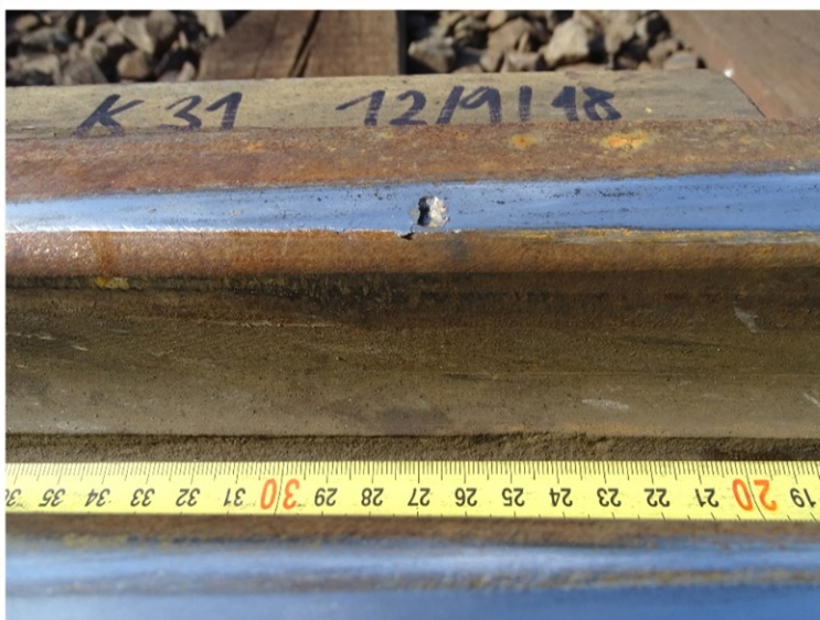
Obrázek 11 - Stav vady 511B před provedeným opravným broušením
